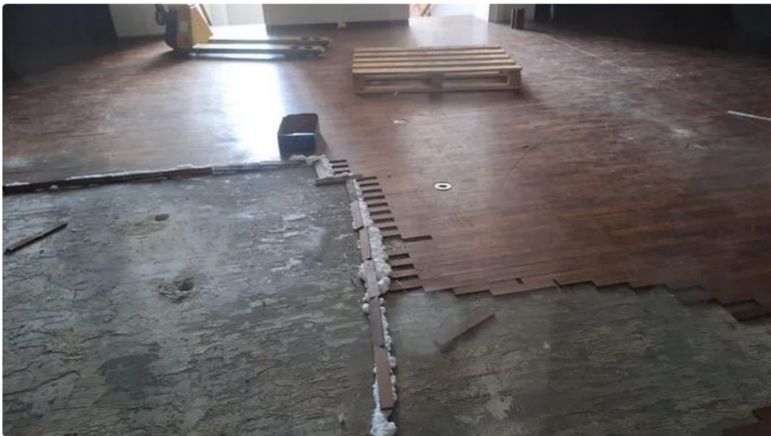
Plusieurs salles du Centre culturel et artistique Jean-Lurçat sont inutilisables à cause d'infiltration d'eau 🇫🇷 © Marielle Camp / France Télévisions
